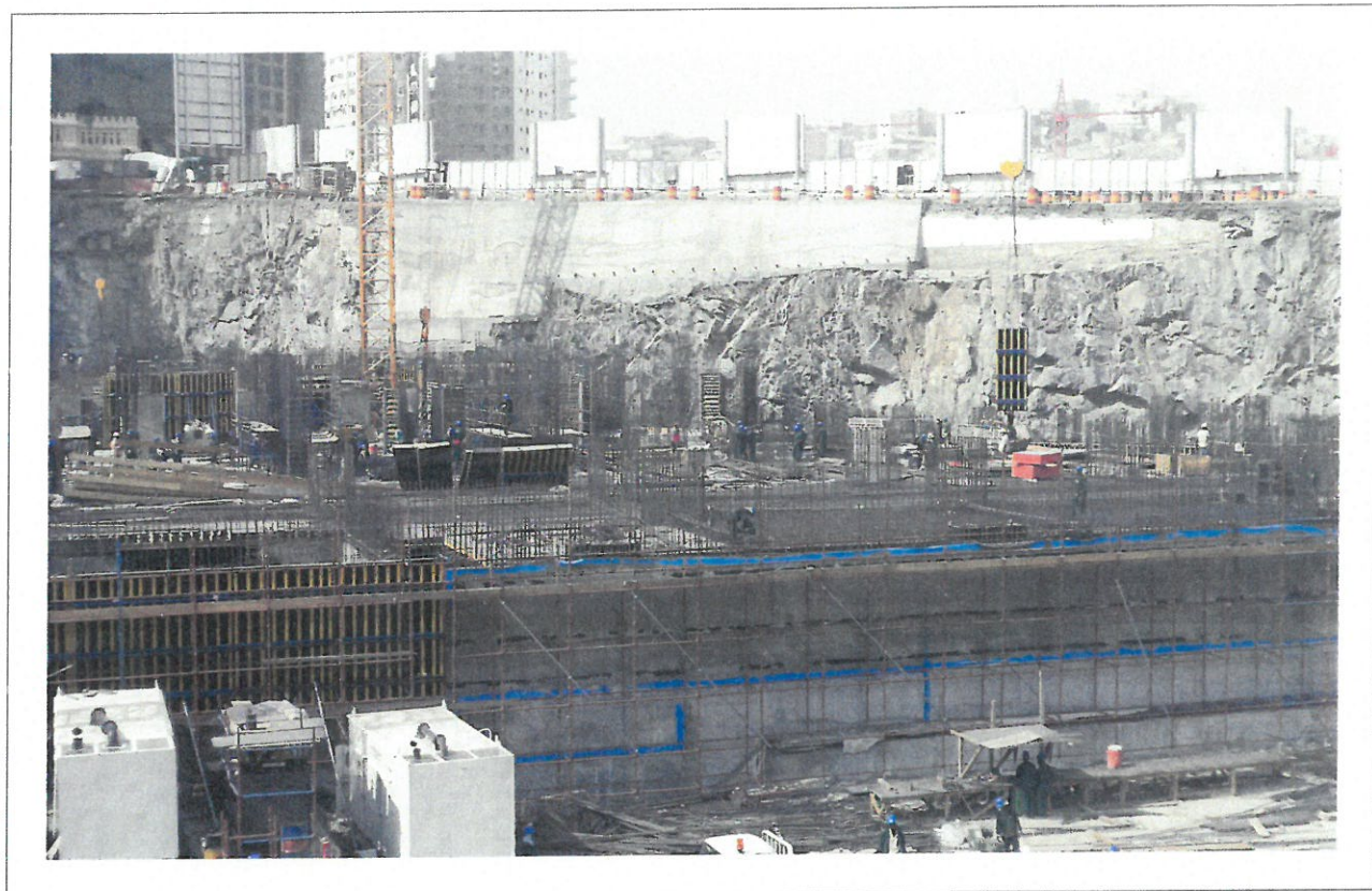
أعمال أساسات المبنى (N3) المنطل على شارع أم القرى والذي سيضم على برجين فندقيين
